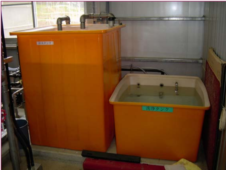
VSEP Process Tanks
