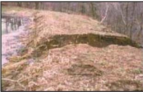
Rotura De la Laguna: Las estructuras de tierra grandes son difíciles de mantener e imprevisible durante el mal tiempo.
