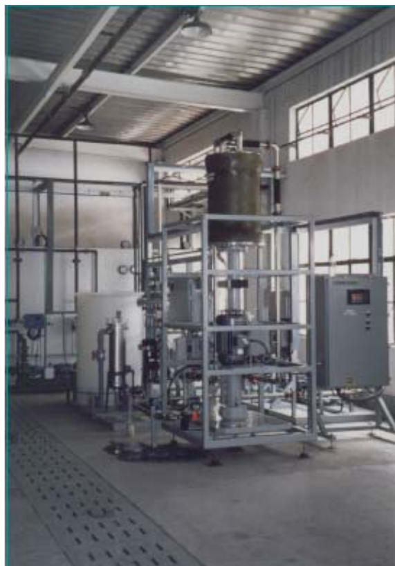
Sistema VSEP instalado en una planta importante para la filtración de agua aceitosa
