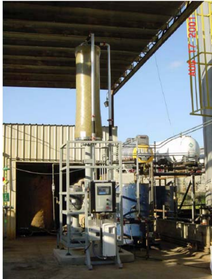
Eine VSEP-Einheit, die Aufstellfläche ist ungefähr 16 SF groß
